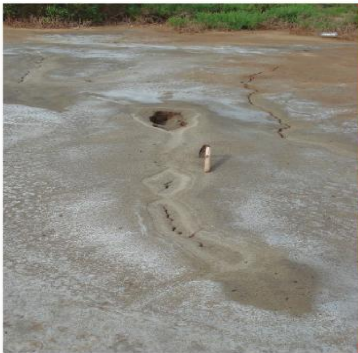
Volcanes de arena en Boca de Tucuyo, producidos por la excitación sísmica a consecuencia del terremoto del 12 de septiembre de 2009. Fuente: Luz M. Rodríguez (2009).
