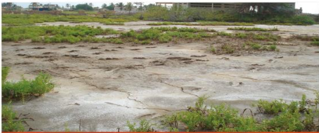
Relajamiento lateral y evidencias de licuación de suelos en Boca de Tucuyo del sismo del 12 de septiembre de 2009. Fuente: Luz M. Rodríguez.
