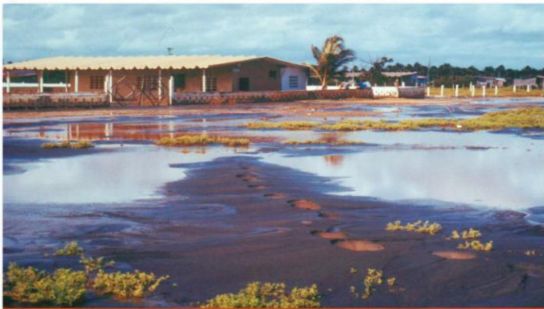
Volcanes de arena gris alineados, así como agua expulsada por licuación de suelos durante los sismos de abril y mayo de 1989 en Boca de Tucuyo estado Falcón. Observe que la casa y los muros perimetrales perdieron la horizontalidad. Fuente: Carlos Beltrán (1989).
